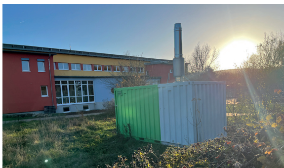
Die Heizzentrale für die Thüngersheimer Nahwärme (Foto: BÜBe)
